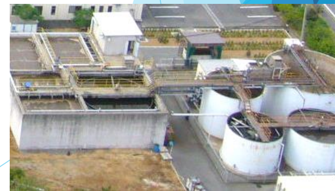
大東工場排水処理設備
