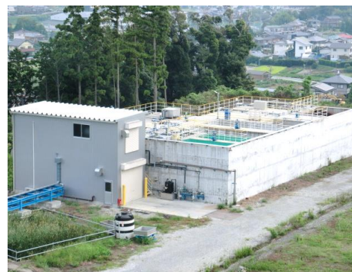
掛川工場排水処理設備
