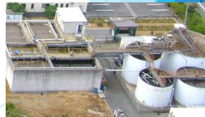
大東工場排水処理設備
