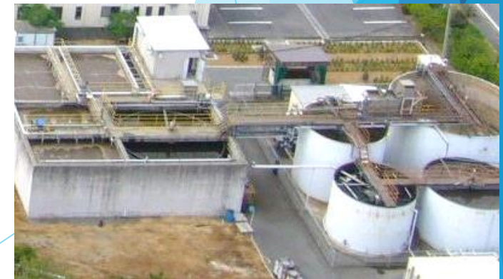
大東工場排水処理設備
