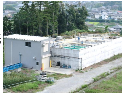
掛川工場排水処理設備
