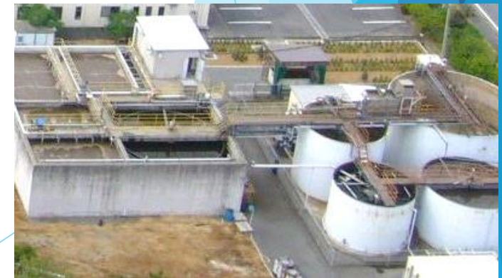
大東工場排水処理設備
