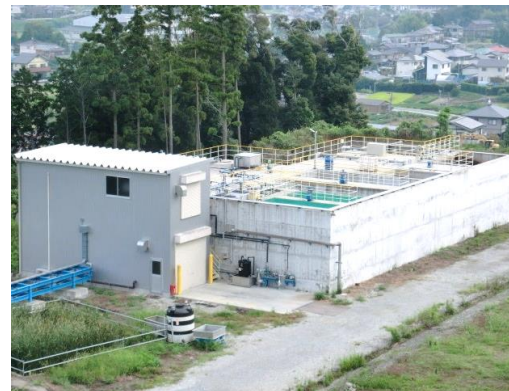
掛川工場排水処理設備
